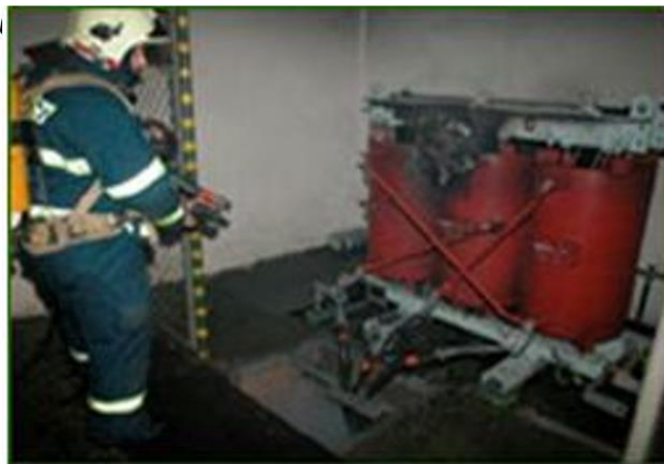
Obr. 4: Zahoření nekvalitního zalévaného transformátoru
