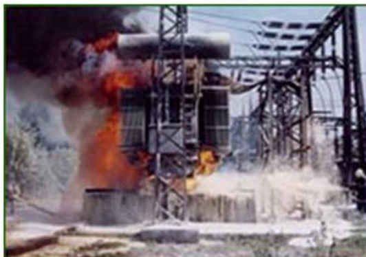
Obr. 3: Požár olejového transformátoru [1]
